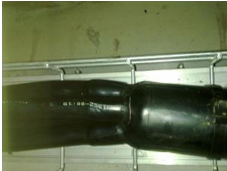
Abbildung 7-1: Risse im Schrumpfschlauch des Mittelspannungskabels.
