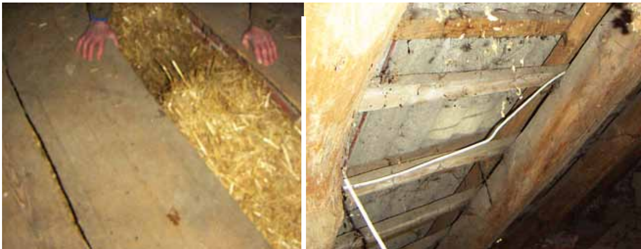
Geringe Dämmung der obersten Geschossdecke mit Stroh und nicht gedämmtes Dach
